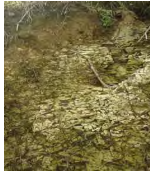
Gambar 8. Litologi tufa yang telah mengalami penurunan kestabilan.
